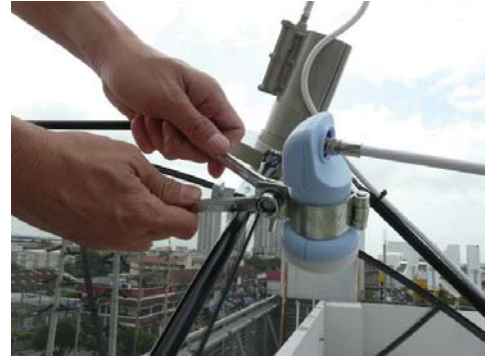
21. เมื่อได้ตำแหน่งที่ดีที่สุด ให้ขันน็อตทุกตัวให้แน่น
